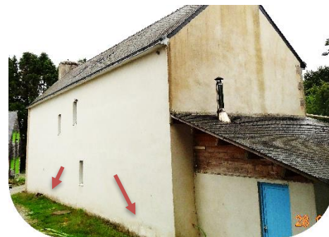
Remontées telluriques en pied de la façade nord
